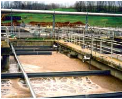
▲ شكل (٢٢) محطة معالجة مياه الصرف الصحي
